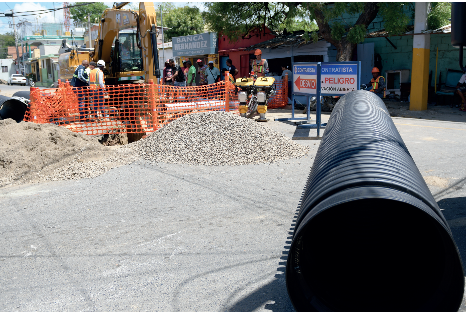
A buen ritmo avanzan trabajos de construcción colector de aguas residuales en Padre Las Casas.
