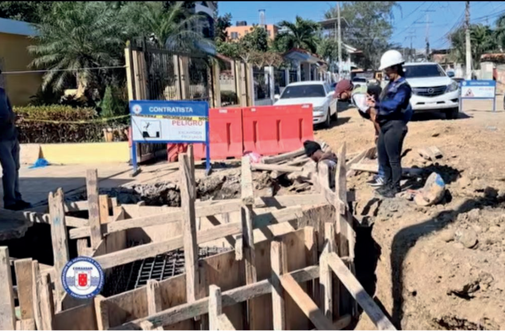
Trabajos de la segunda etapa de la instalación del anclaje que servirá como soporte para la tubería de impulsión de 30 pulgadas de la avenida Emilio Prud'Homme esquina Fernando Bermúdez en Bella Vista.
